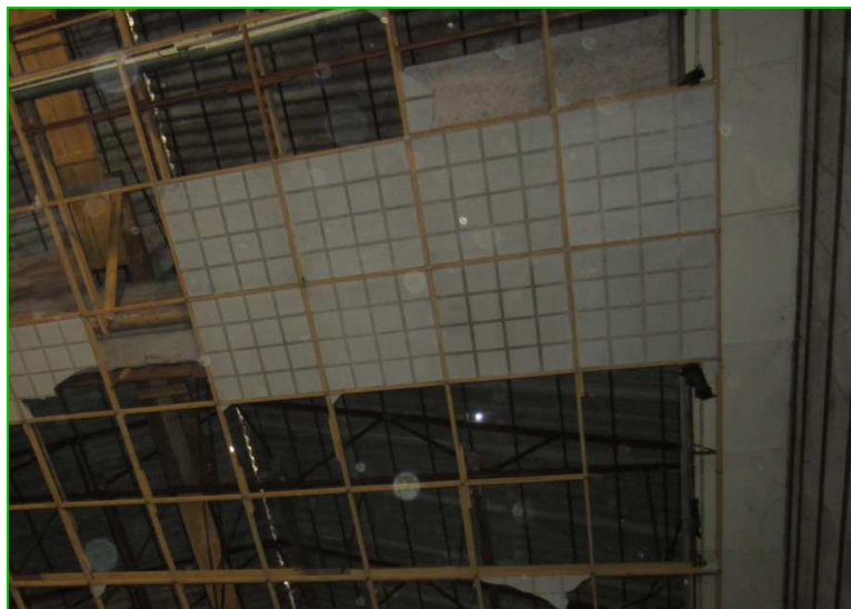
Pannelli di controsoffitto in cemento-amianto e floccato
