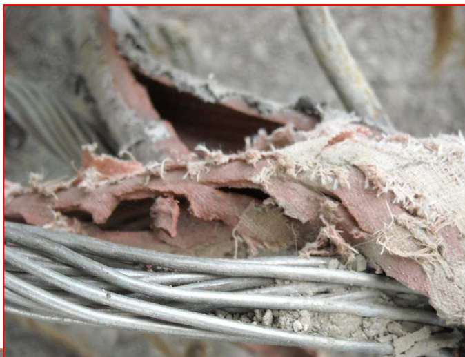
Rivestimento di cavi elettrici in garza contenente amianto
