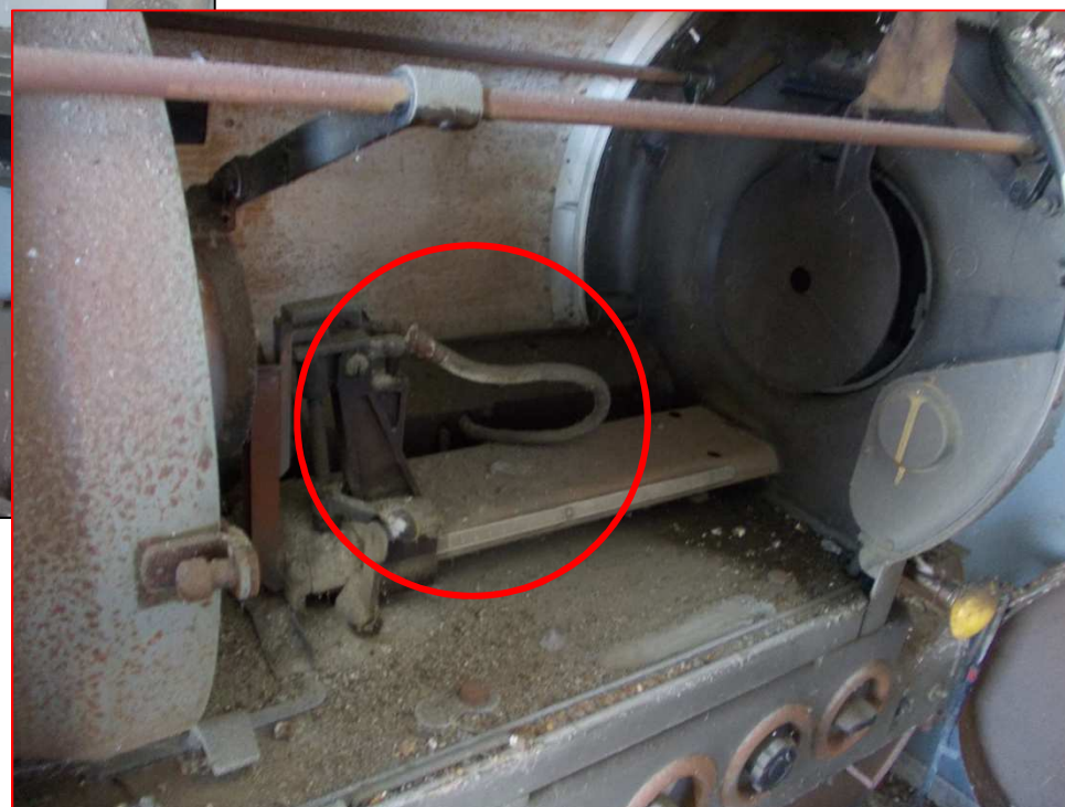
Cavo rivestito in amianto all'interno di proiettore
