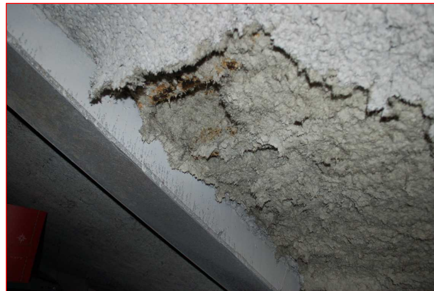
Rivestimenti in amianto floccato
