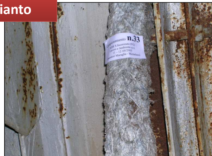
Corda contenente amianto
