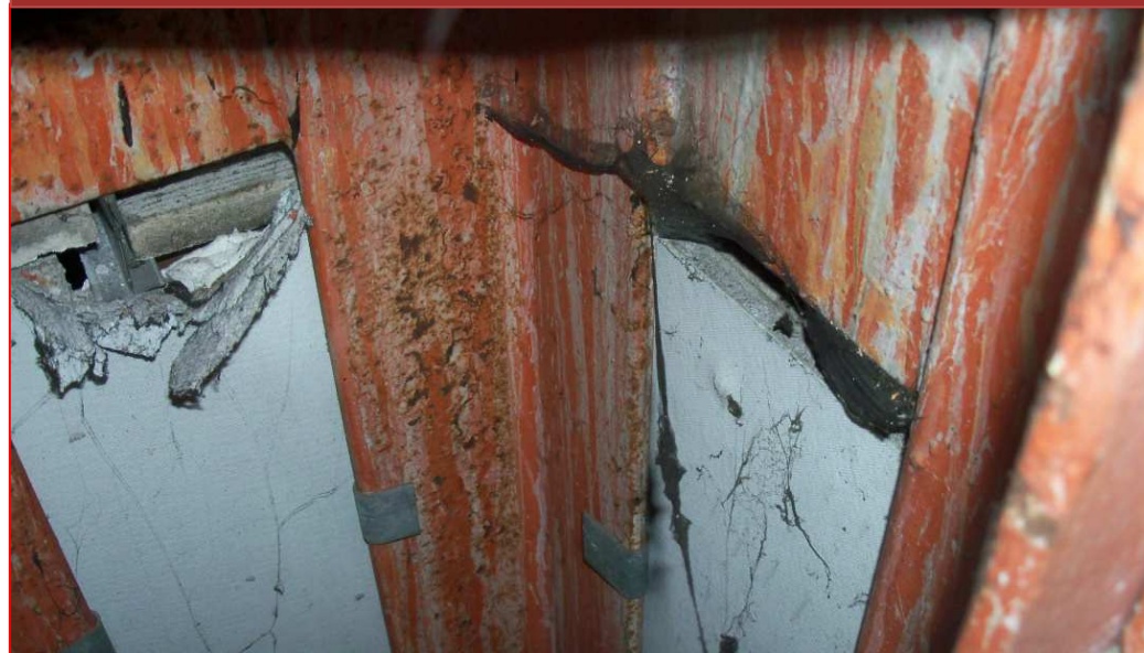
Pannelli con cartone di amianto all'interno
