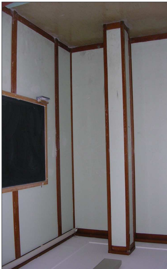
Pareti con cartone di amianto all'interno
