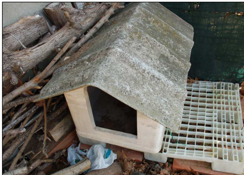
Tetto di cuccia in cemento-amianto
